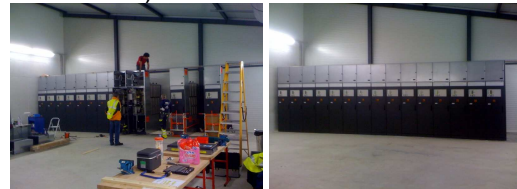
Figura 5- Proceso de montaje en campo (izda) y celdas de media tensión de una subestación en Centro Europa (dcha)
